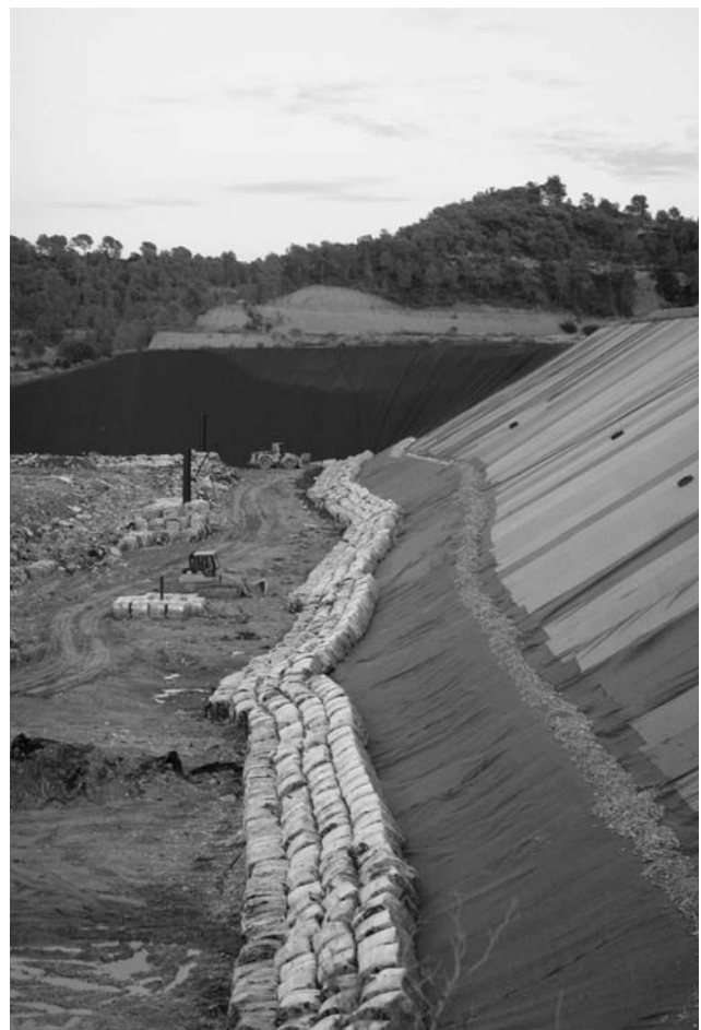
Després que els informes encarregats van concloure que no afectava l'aquífer, l'abocador va entrar en funcionament al mes d'octubre. Foto: Marta Casas
