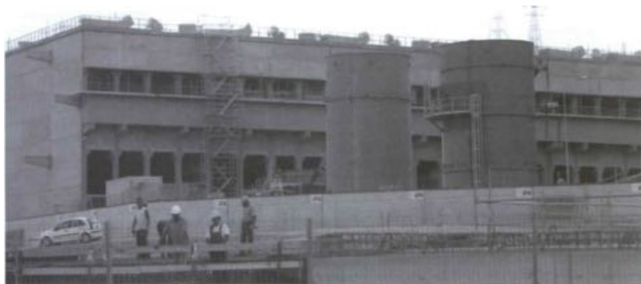
La instal·lació, que es preveu que entri en funcionament a mitjan del 2007, tindrà una potència total de 800 MW. Foto: Maria Casas.
